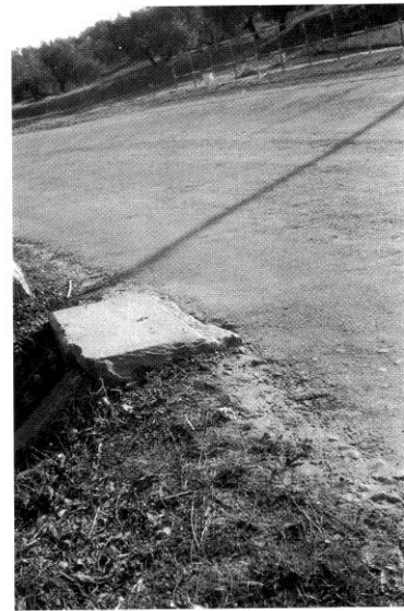
Curva de la Fuentecilla antes de arreglarse
